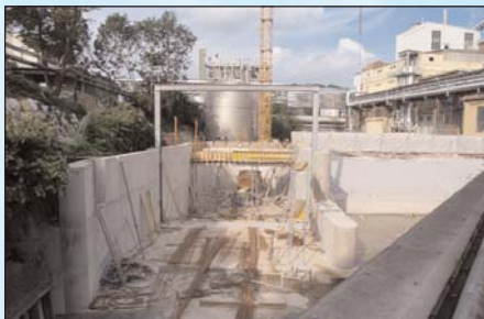
Baustelle Lenzing war 5-mal überflutet Foto: ZeK
