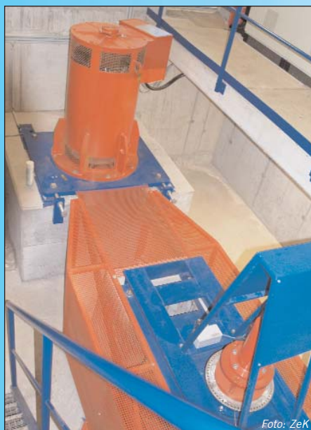
Eine GHE-Kaplan-Turbine rotiert im Krafthaus
