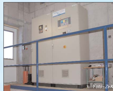
Die Steuerung kam keineswegs von der Stange
