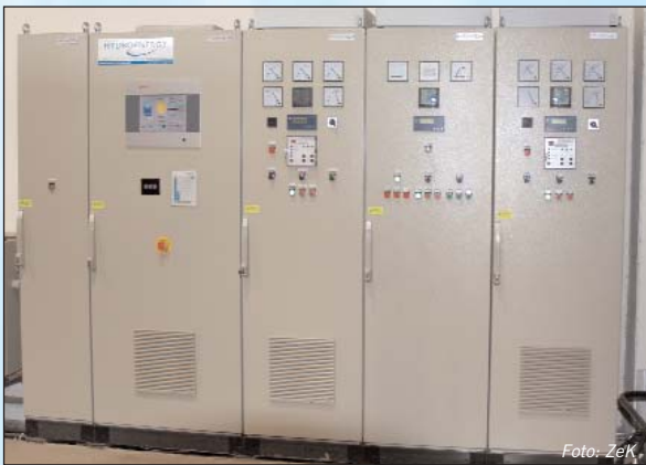
Das „Gehirn“ der Anlage: die Steuerungsanlage von GHE. Letzte technische Details wurden im Frühling '06 vor Ort integriert.
