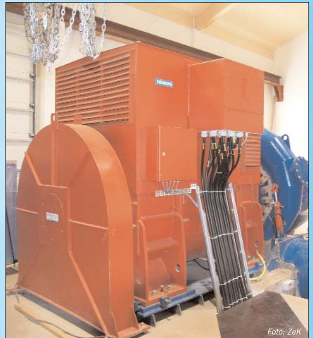
Ein Siemens Generator im KW Mulavirkjun. Leistung: 150 kVA
