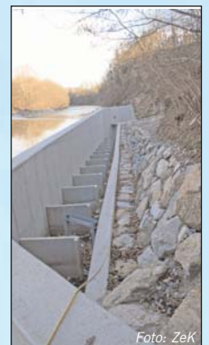
Fischaufstiegshilfe in Vertical-Slot-Bauweise: Geschützt von einer Hochwasserschutzwand Foto: ZeK
