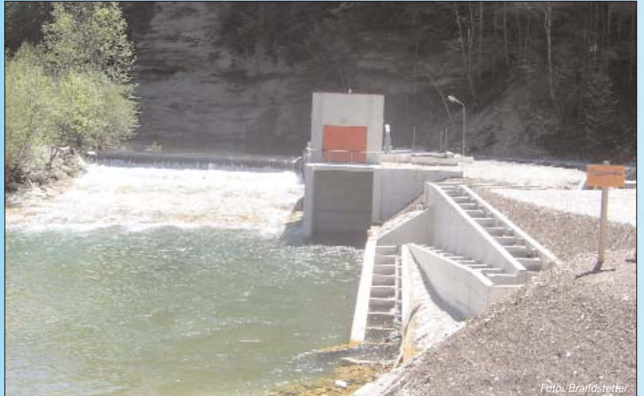
Rund 2,5 GWh mehr bringt das KW Pankraz im Verbund mit dem neuen Wehrkraftwerk Teichl
