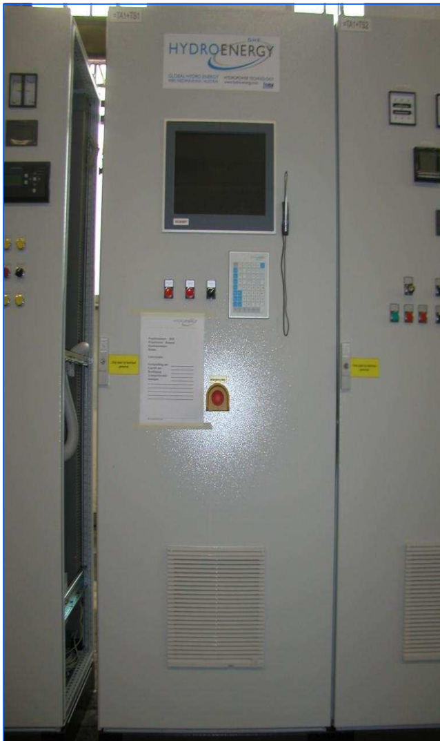
Schaltzchränke Control Cubicles
