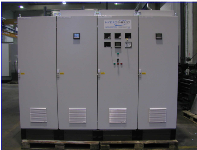
Elektrische Schaltanlage Electrical control system
