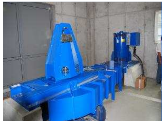
Inbetriebgenommene Kaplan Turbine Installed Kaplan Turbine
