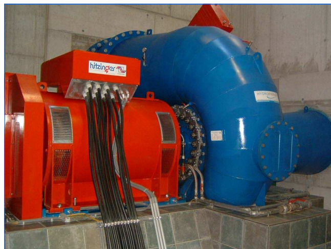
Turbine mit Generator Turbine with Generator
