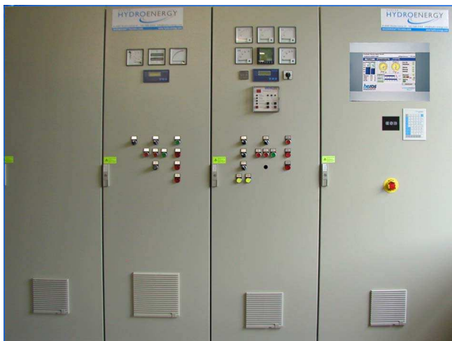
Niederspannungsschaltanlage mit Turbinenregler LV switchgear with Turbine Governor
