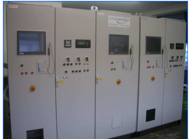
Elektrische Schaltanlage electronical control station
