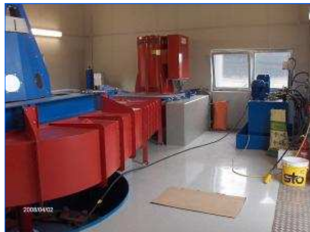
Im Turbinenhaus Inside of the power house
