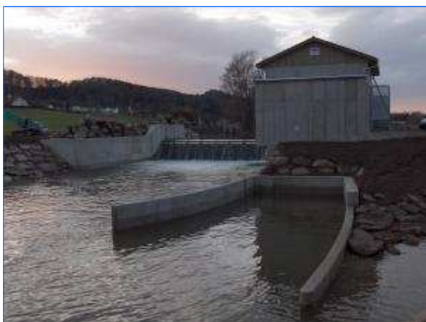
Turbinenauslauf Power House
