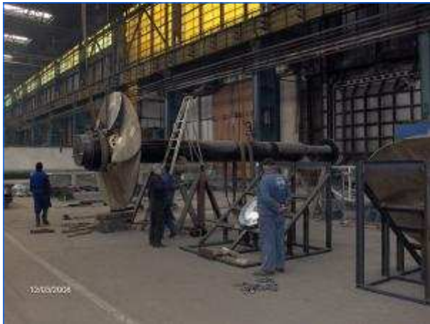
Kaplanlaufrad auf Turbinenwelle montiert Kaplan runner mounted on turbine shaft
