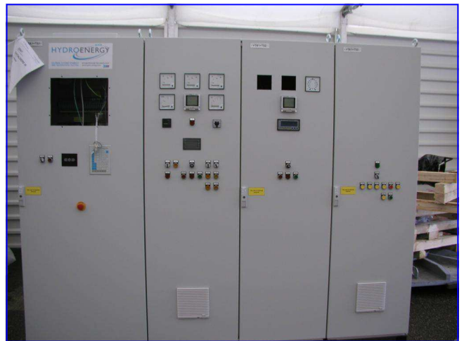
Elektrische Schaltanlage Electronical control system
