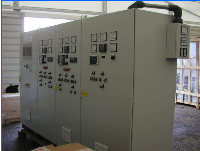
Elektrische Schaltanlage Electronical control system
