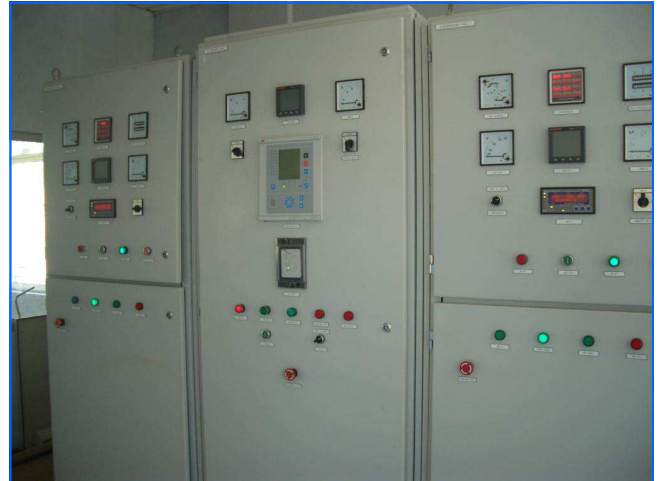
Elektrische Schaltanlage Electrical control system
