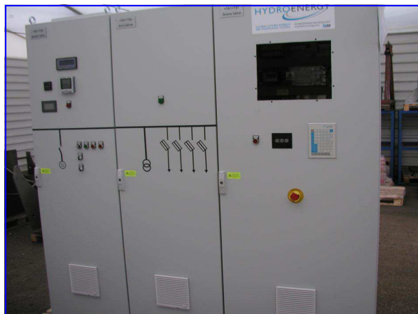
Elektrische Schaltanlage electronical control system
