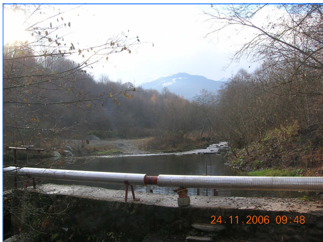
Einlaufrohrleitung Inlet penstock
