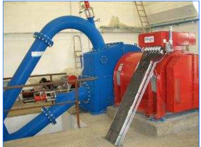
Turbine mit Generator Turbine with Generator
