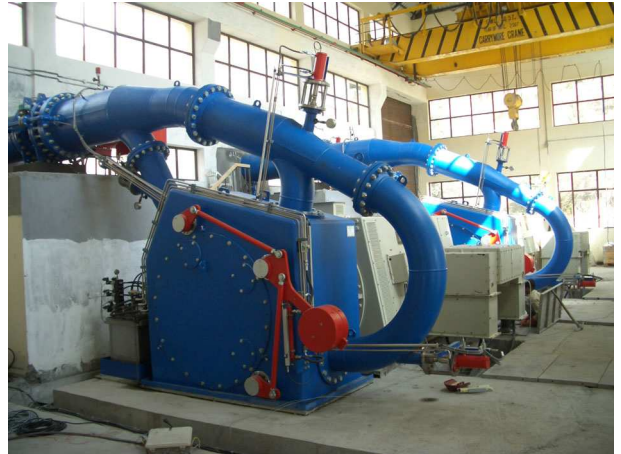
Pelton Turbinen beim Einbauort Pelton Turbines at installation site
