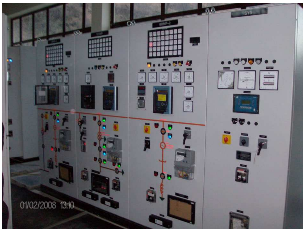
Schaltanlage Switch gear
